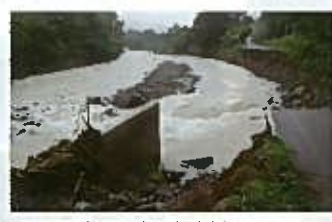
▲豪雨災害で賀老川が氾濫。道や国に緊急措置を要請
